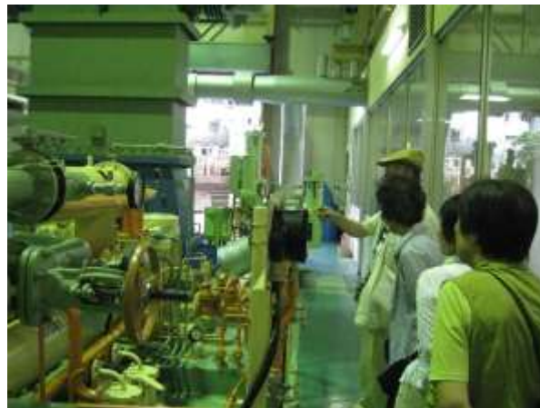
タービン発電機
