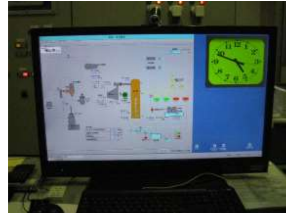
監視制御装置
