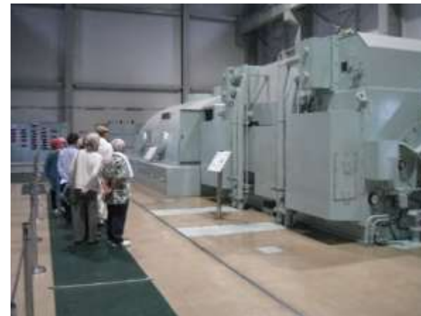
蒸気タービン・発電機
