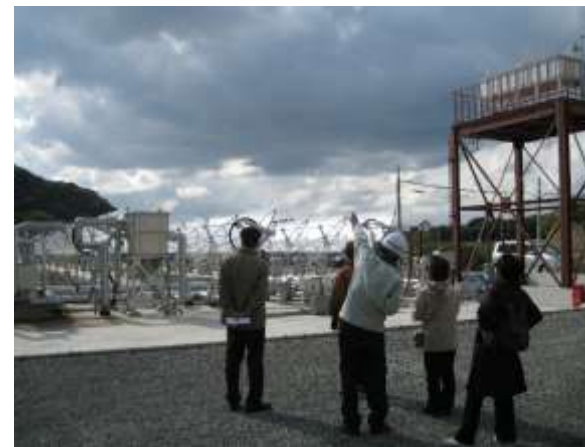
⑩トラフ型太陽熱バイナリー発電 南あわじ市:太陽集熱器東芝
