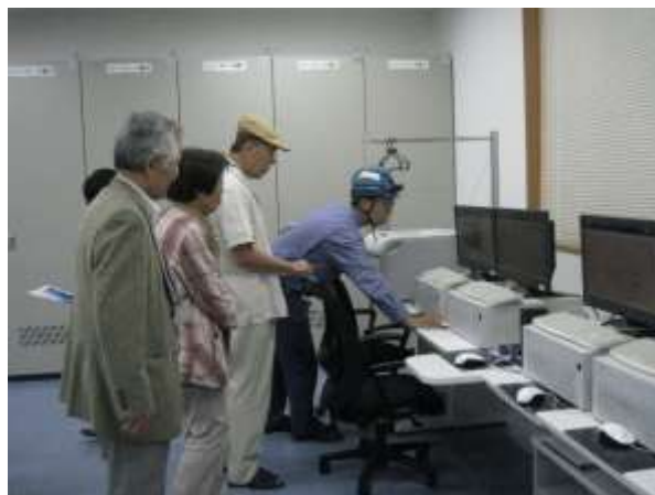
監視制御装置
